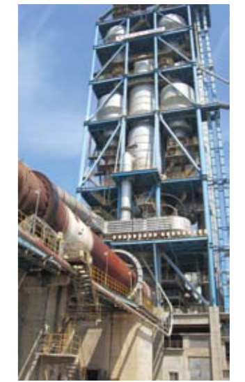
中材湘潭水泥公司分级燃烧脱硝系统 Sinoma Xiangtan Cement Co.,Ltd air stage combustion denitration system
